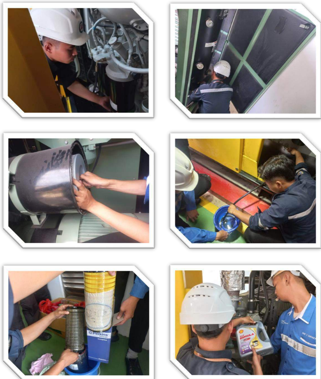
Gambar 2.9 Perawatan 12 Bulanan Genset dan Kompresor di Depo KRL Solo Jebres
