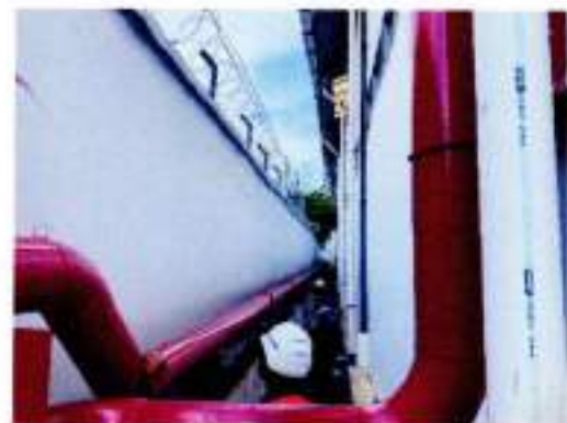
Pipa Hidrant Barat
