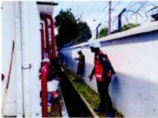
Pipa Hidrant Utara Pompa
