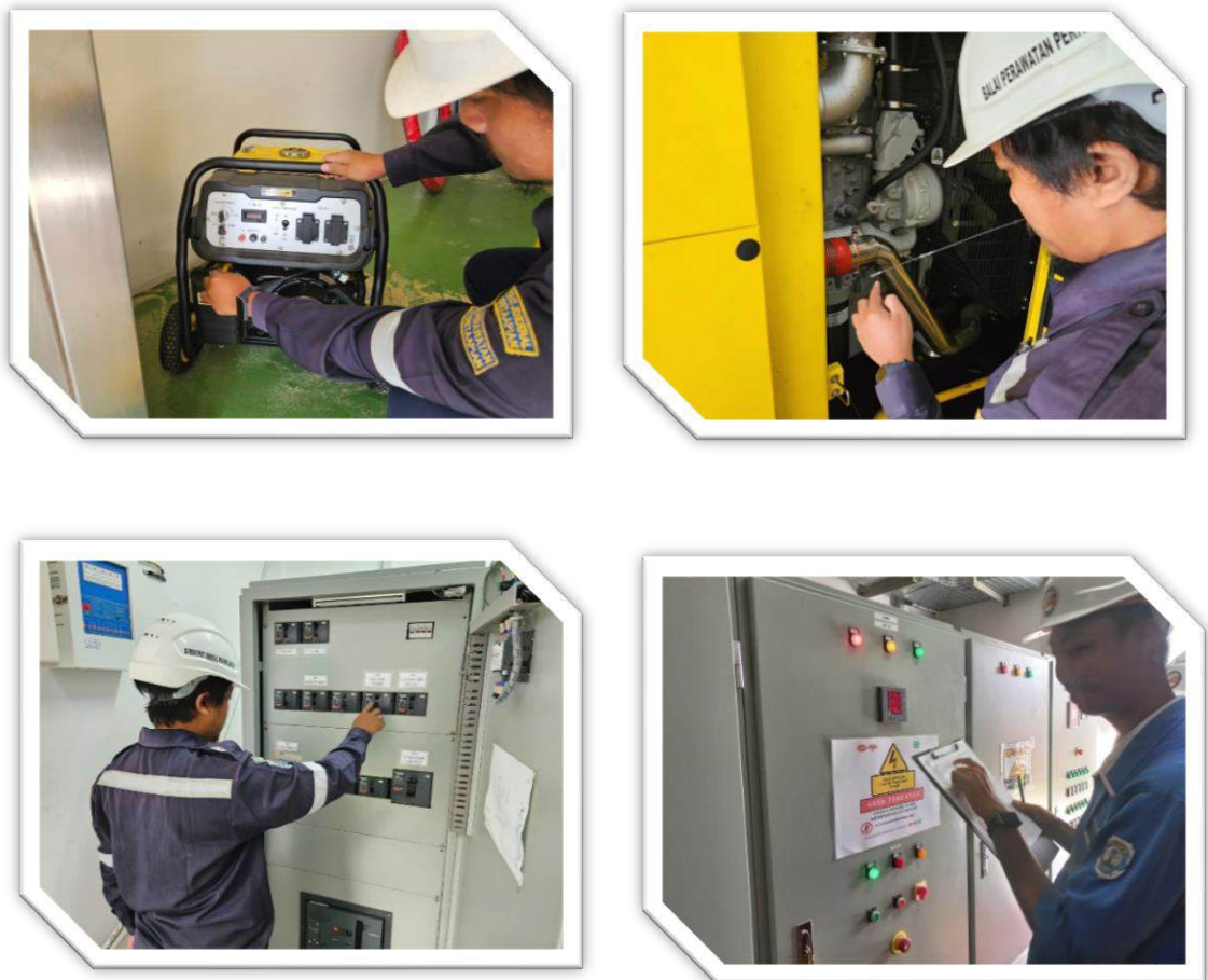
Gambar 2.10 Pemeriksaan Kelistrikan Depo
